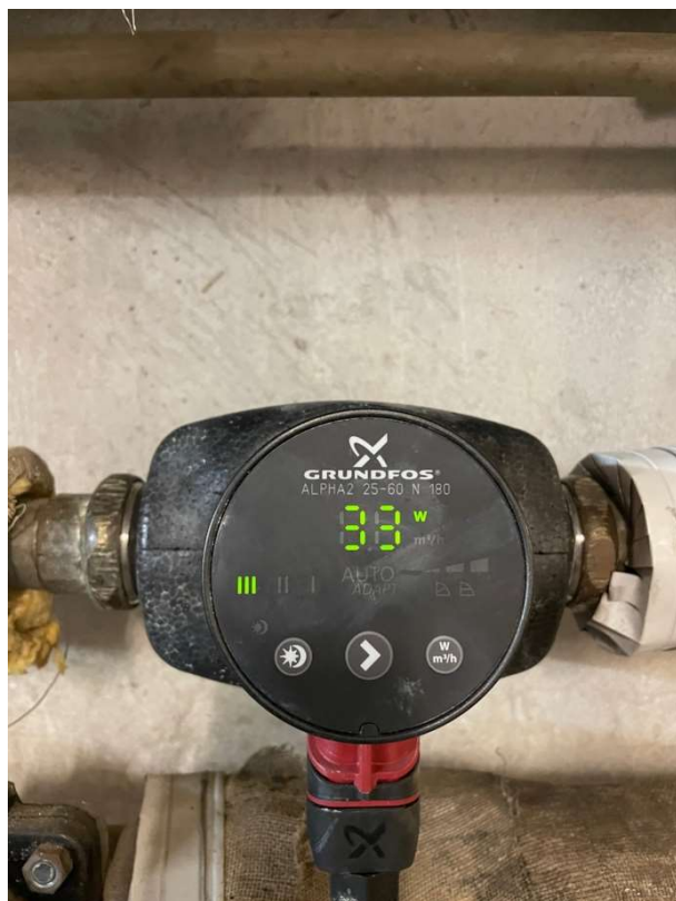
Cirkulationspumpe til varmt brugsvand
