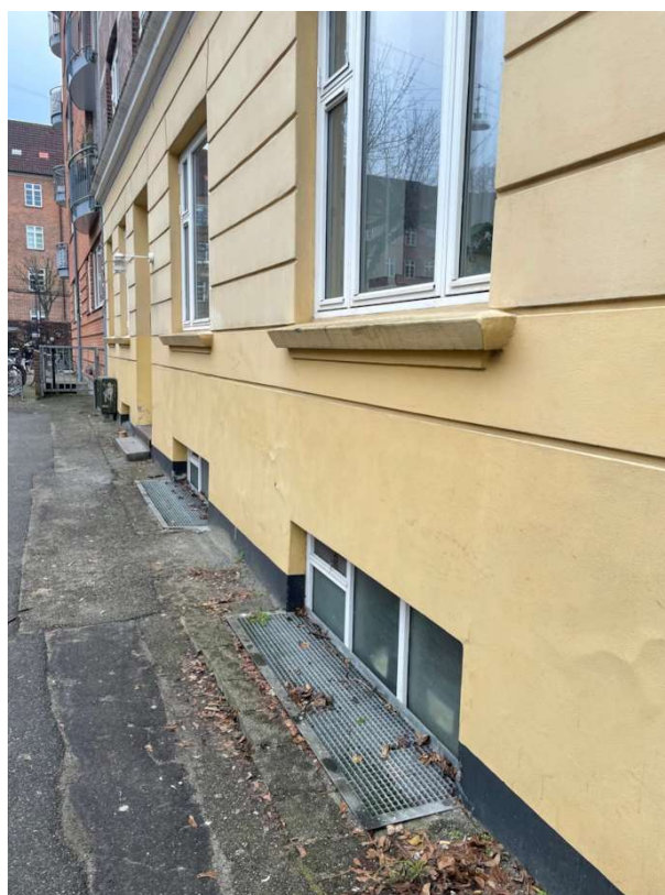
Revnedannelse og lunker omkring lyskasser
