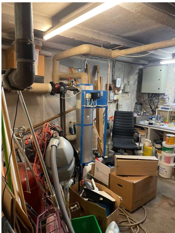
Løst hængende kabler
