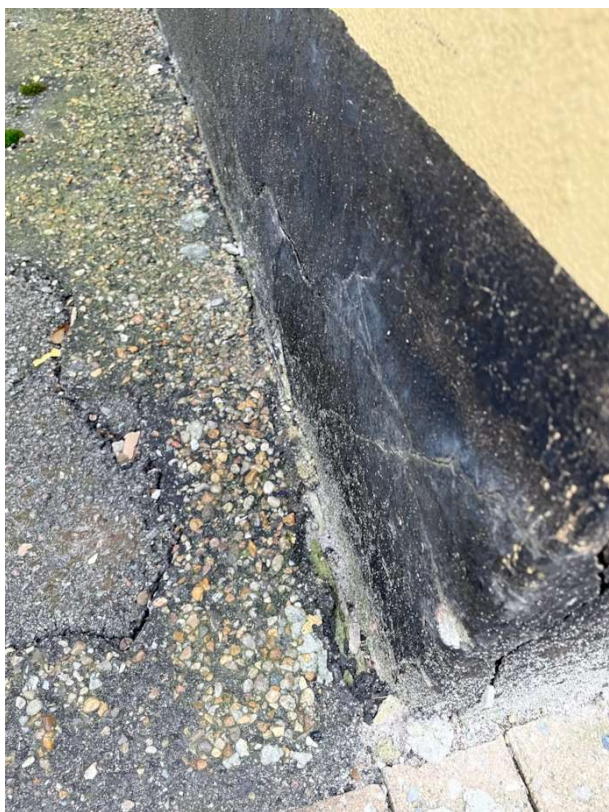
Revnedannelse i asfalt omkring sokkel mod gård
