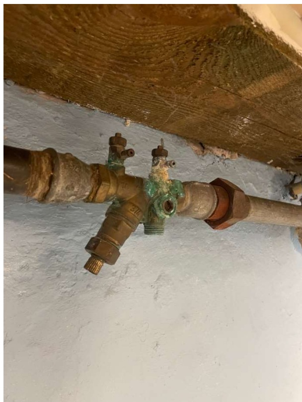
Lokale tæring i installationer
