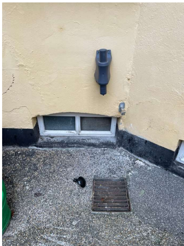
Belægning som asfalt ind mod facade
