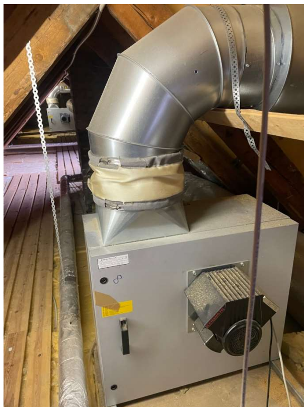
Boxventilator i loftsrum - Flexkrave er i tilstrækkelig stand
