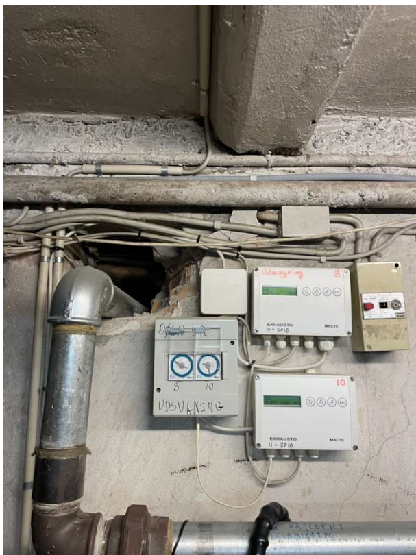
Utilstrækkelig gennemføring til fyrrum
