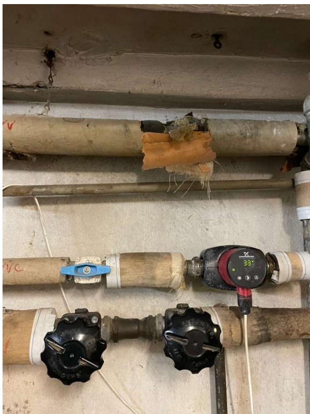
Cirkulationspumpe til varmt brugsvand
