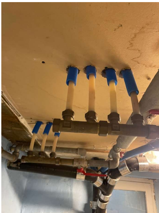
Utilstrækkelig gennemføring af brugsvand i brandsektion
