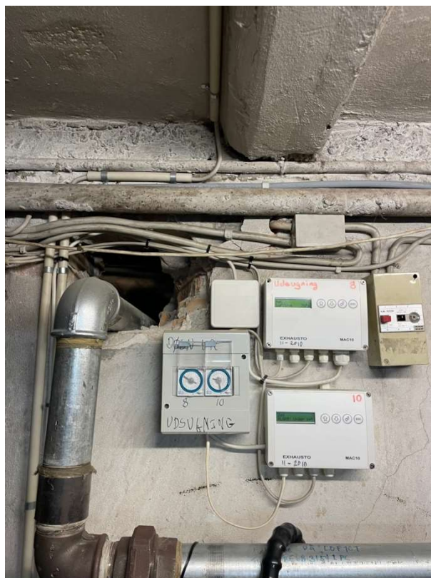
Utilstrækkelig gennemføring i sektionsvæg
