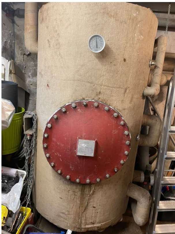
Beholder fremstod ved besigtigelse uden isoleret dæksel
