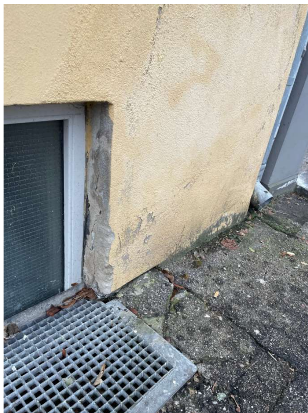
Facadepuds er ikke ført under terræn - revnedannelse
