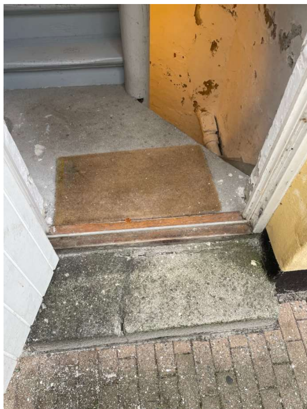
Revnedannelse i støbte optrin mod bagtrapper
