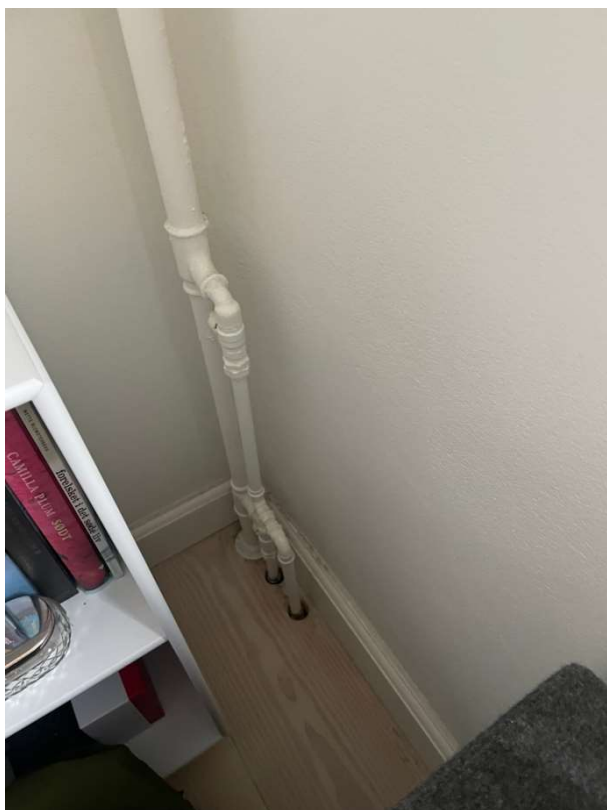
1-strengs radiatoranlæg - stigstrenge fremstår uden tæringer
