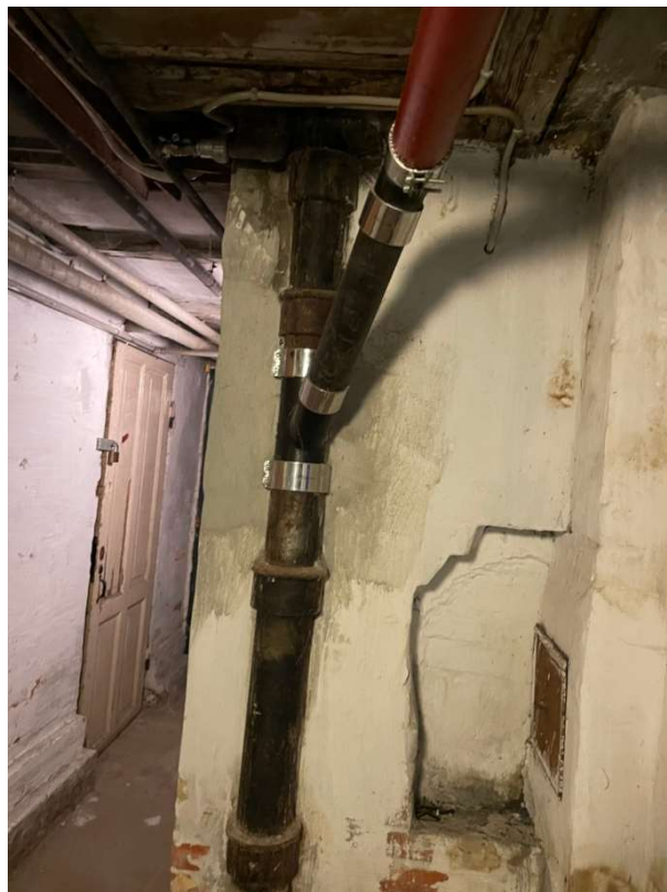
Overgang af nyere installationer til ældre faldstammer
