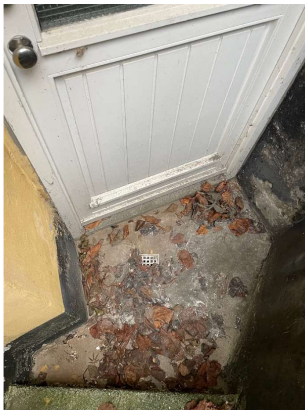
Generelt manglende friholdelse af afløb i skakt
