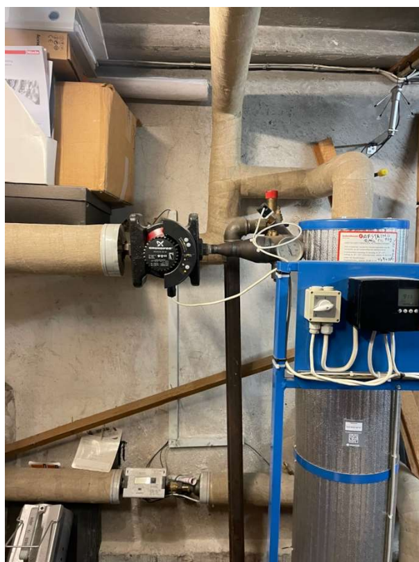
Cirkulationspumpe - varmeproducerende anlæg - varmeveksel
