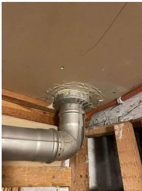
Utilstrækkelig brandsikring af gennemføring
