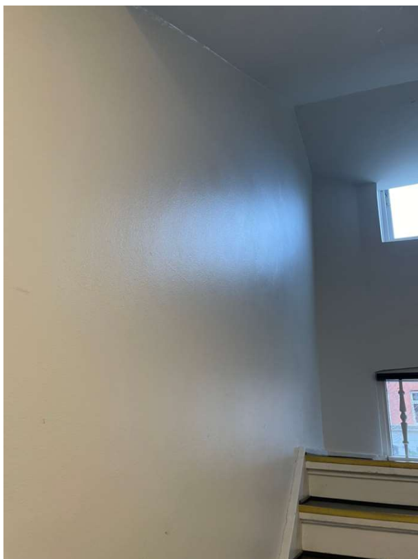
Hovedtrapper fremstår kun i et meget begrænset omfang med "flytteskader"
