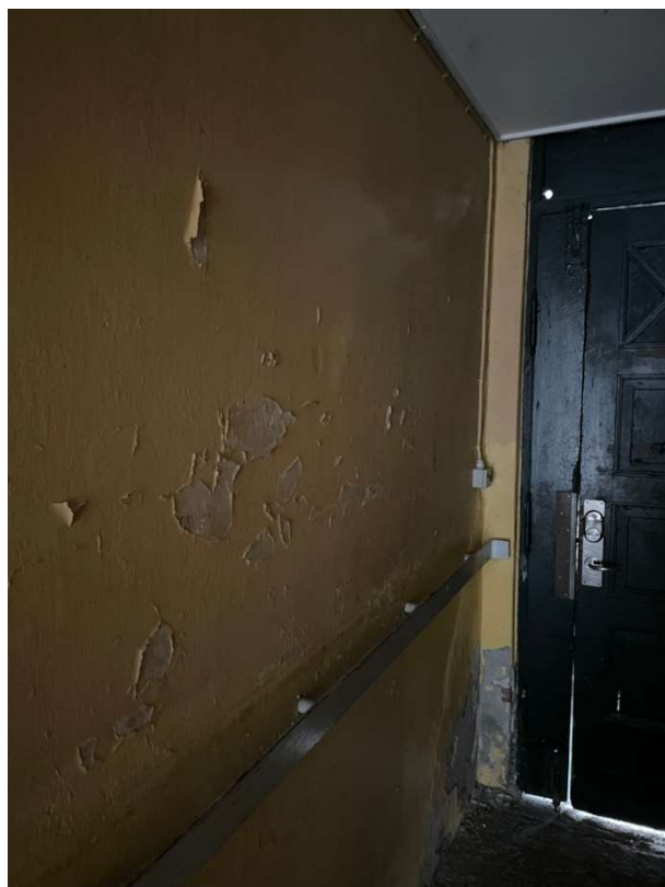
Nedfalden maling i gennemgang
