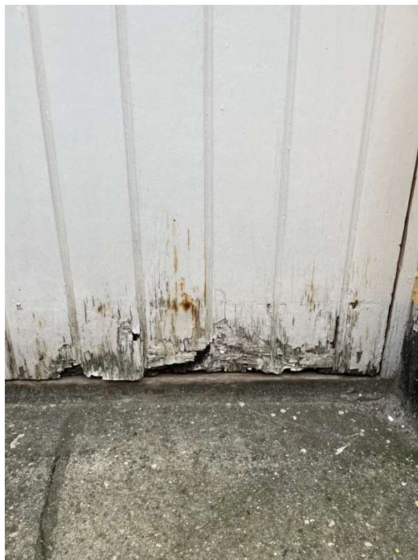
Begyndende delaminering og træedbrydning omkring gående dørblad
