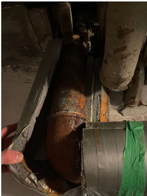
Tæring på installationer i kælder
