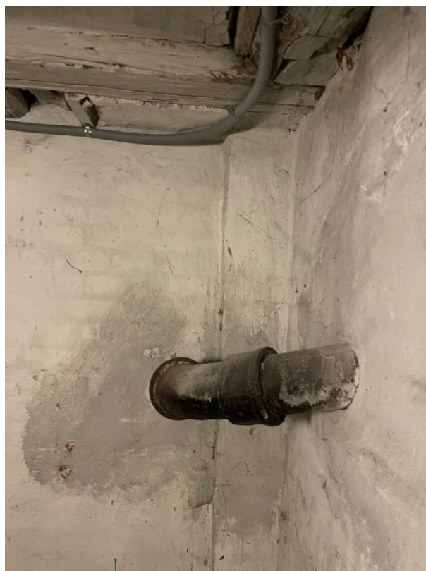
Oprindelige faldstammer i støbejern
