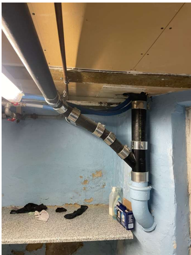
Overgang af nyere installationer til ældre faldstammer
