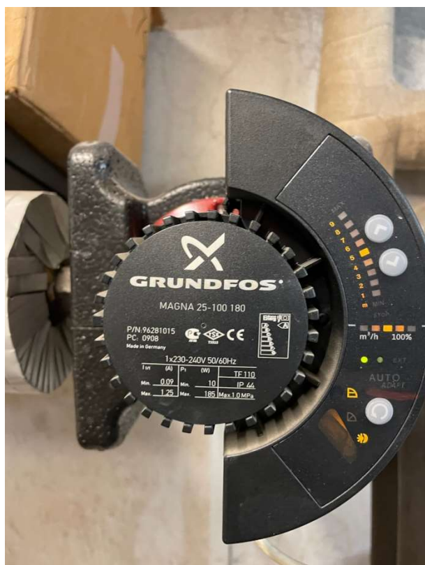
Cirkulationspumpe - varmeproducerende anlæg
