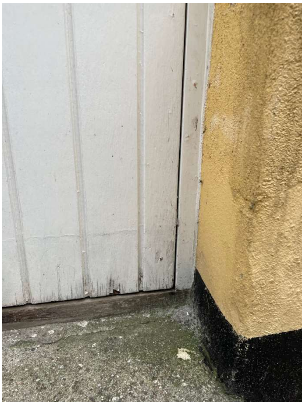
Begyndende delaminering og træedbrydning omkring gående dørblad
