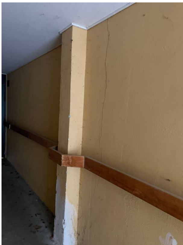
Vertikale revnedannelse i gennemgang
