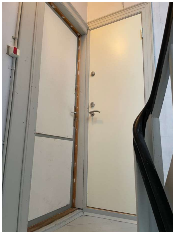
Døre fra lejligheder til bagtrappe - udført med eftermonterede pladebeklædning
