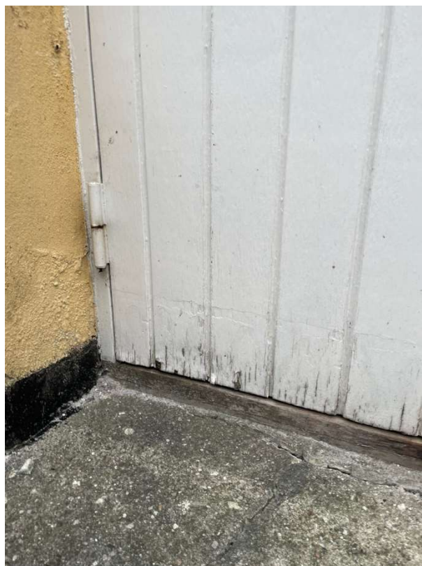
Begyndende delaminering og træedbrydning omkring gående dørblad
