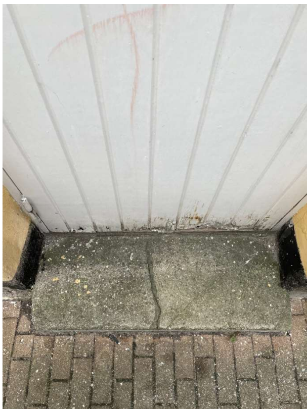
Revnedannelse i støbte optrin mod bagtrapper
