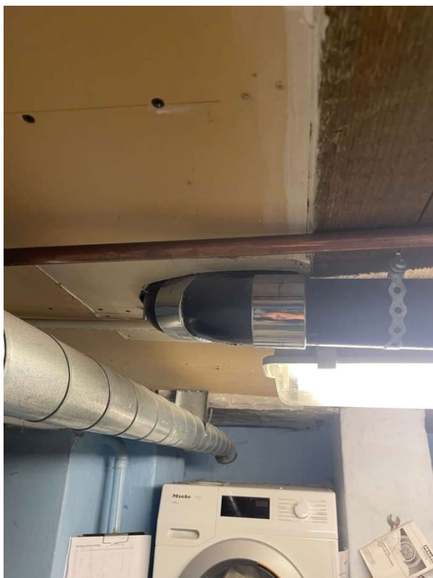
Utilstrækkelig brandsikring af gennemføring
