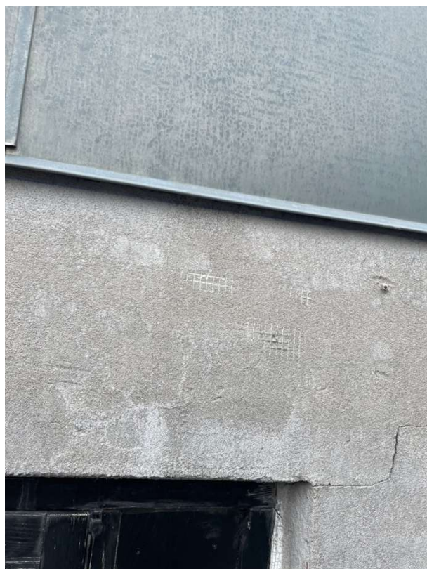
Facade mod gård: Tidligere forsøg på reparation af tyndpuds
