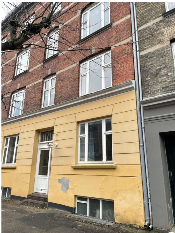
Facade mod gade: Opfugtet underfacade
