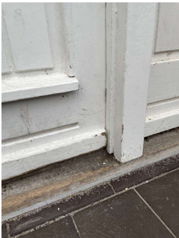
Lokale brugsspor omkring opgangsdør mod gade
