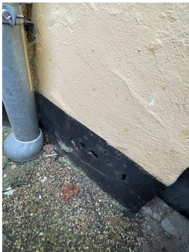
Facade mod gård: Opstigende grundfugt og revnedannelse i pudsbehandling
