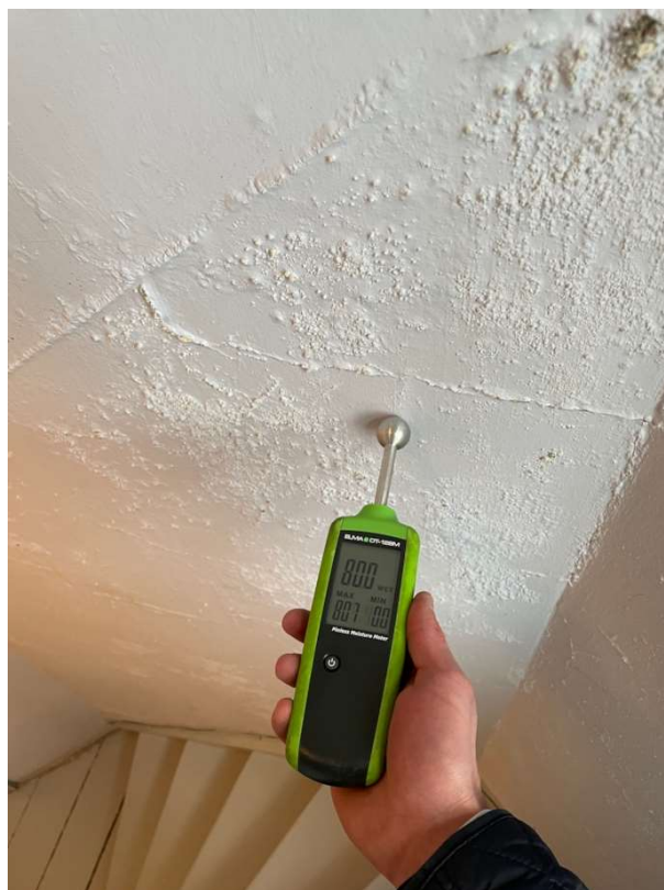
Facade mod gård: Fugtmåling på indvendig side af pudsskade, trappetårn - 80%
