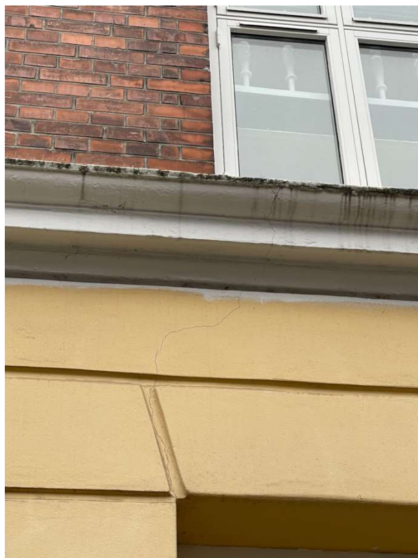
Facade mod gade: Revnedannelse omkring gesimsbånd
