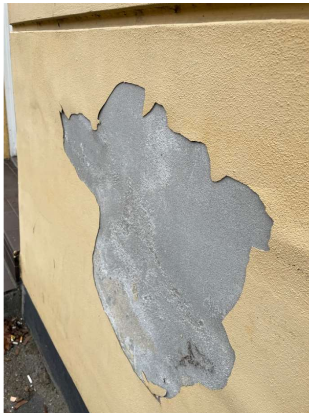
Facade mod gade: Opfugtet underfacade
