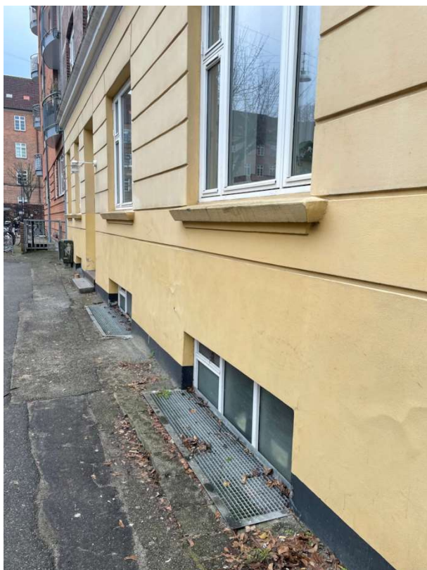
Facade mod gade: Opfugtet underfacade
