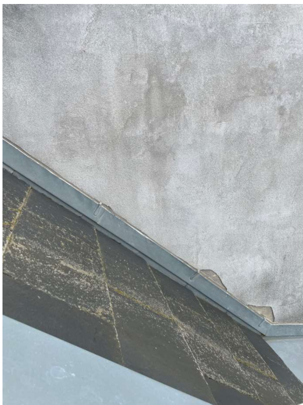
Facade mod gård: Nedfald af tyndpuds på trappetårne, flunker
