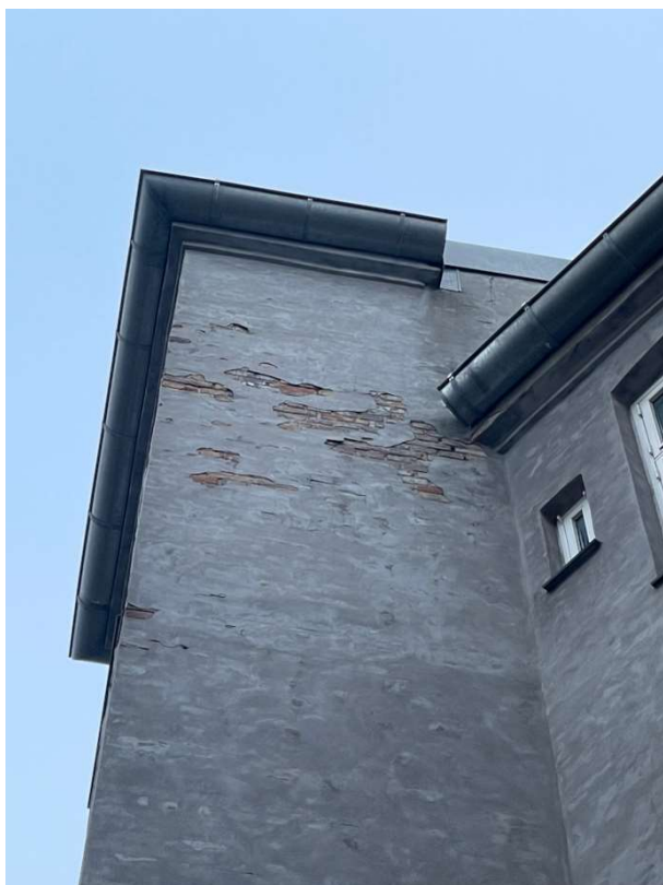
Facade mod gård: Nedfald af tyndpuds på trappetårne
