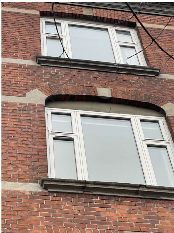
Facade mod gade: Porøst og udvasket murværk, sætningsskader og revnedannelse i sålbænke
