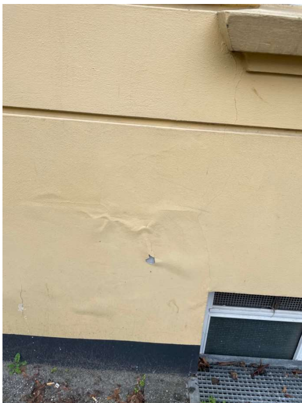
Facade mod gade: Opfugtet underfacade
