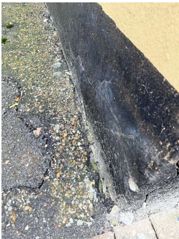
Facade mod gård: Opstigende grundfugt og nedfald af sokkelpuds
