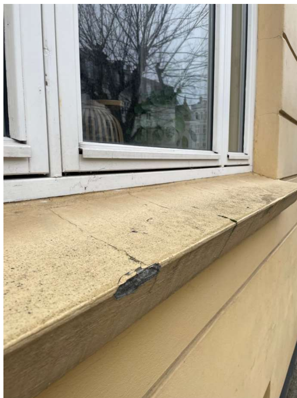
Facade mod gade: Revnedannelse i støbte sålbænke
