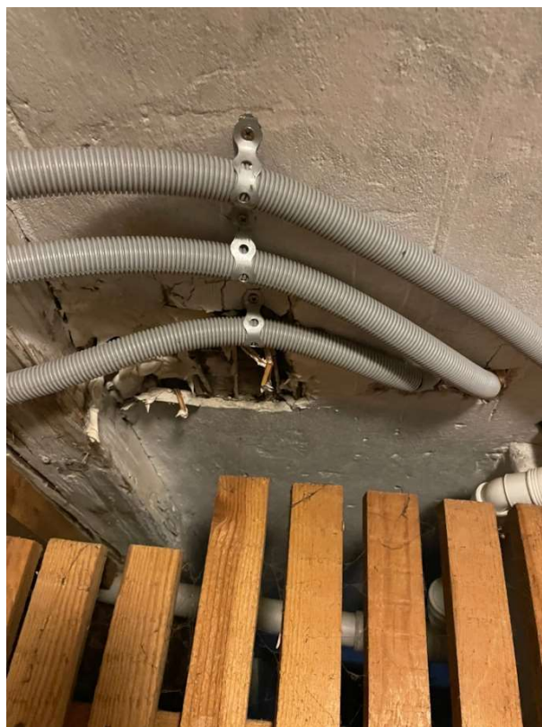
Utilstrækkelig gennemføring i etageadskillelse - generelt billede af gennemføringer
