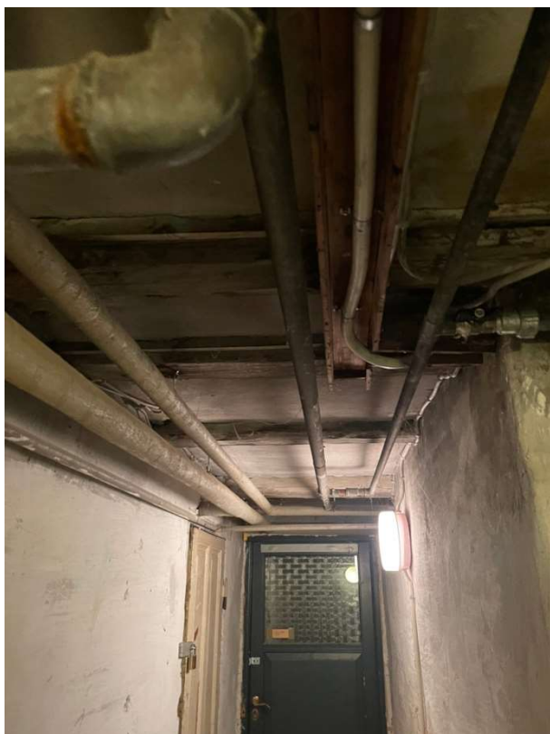
Utilstrækkelig brandsikring af bjælkelag
