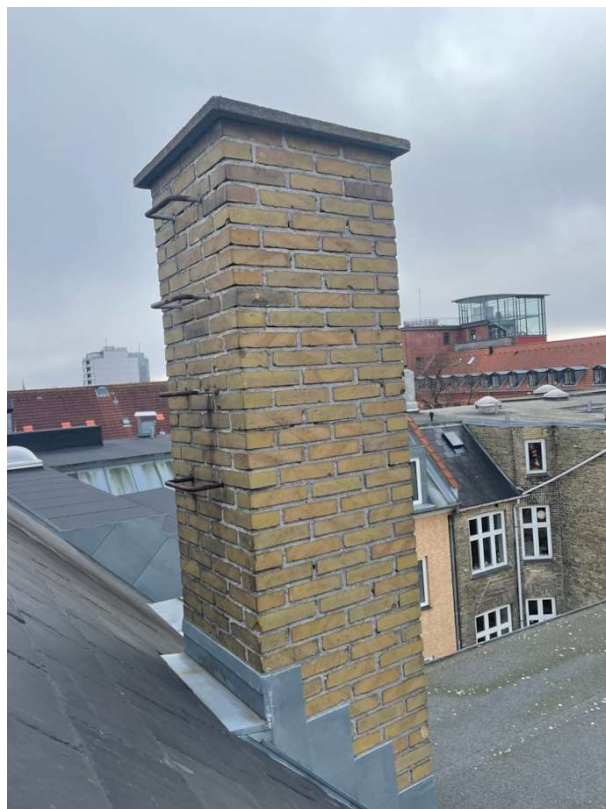
Skorsten fremstår med lokale svindrevner - og udfaldne mørtelfuger
