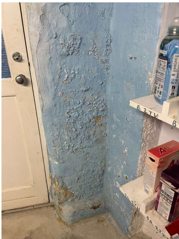
Opstigende grundfugt samt saltudtræk
