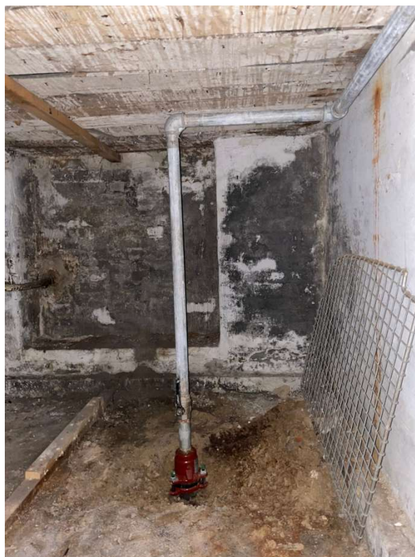
Utilstrækkelig etageadskille samt opfugtet kælderydervæg
